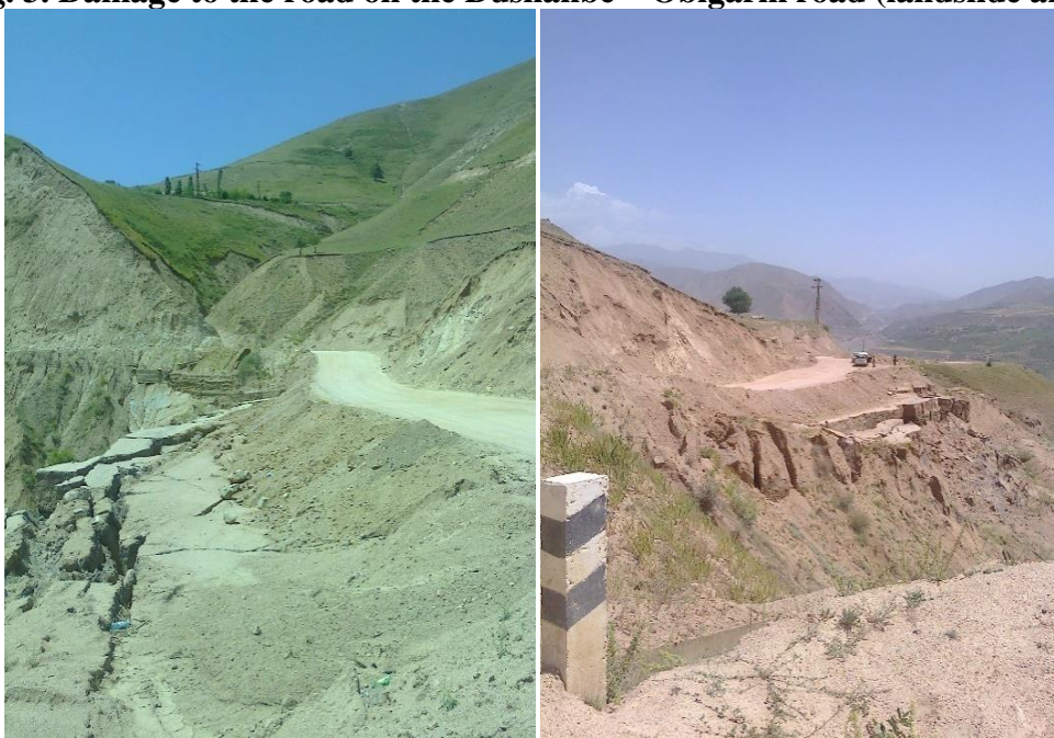
Рис. 3. Повреждение автодороги на трассе Душанбе –Обигарм (оползневой участок) Fig. 3. Damage to the road on the Dushanbe – Obigarm road (landslide area)
