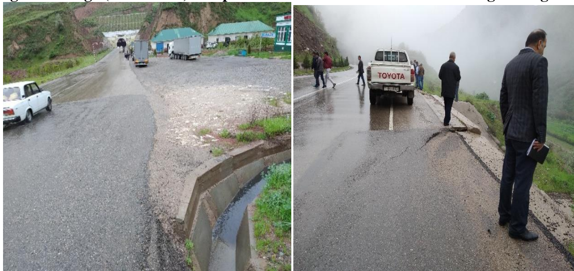
Рис. 1. Повреждение (просадка) части автодороги на трассе Душанбе-Дангара Fig. 1. Damage (drawdown) of a part of the road on the Dushanbe-Dangara. highway
