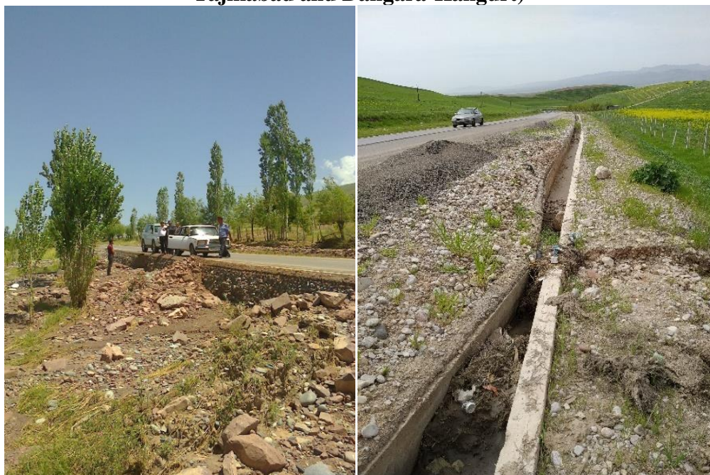
Рис.2. Повреждение водосборных бетонных лотков и просадка части автодороги (Гарм-Таджикабад и Дангара-Кангурт) Fig.2. Damage to water discharge concrete chutes and drawdown of a part of the road (Garm-Tajikabad and Dangara-Kangurt)
