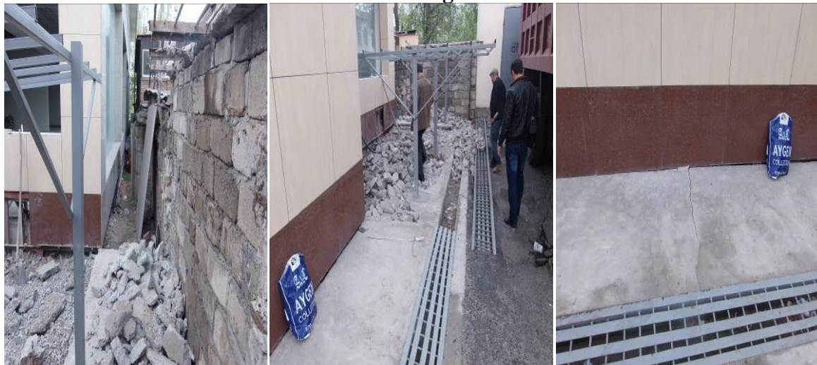
Рис.5. Характер повреждений бетонной отмостки с левой стороны здания Fig. 5. The nature of the damage to the concrete blind area on the left side of the building
