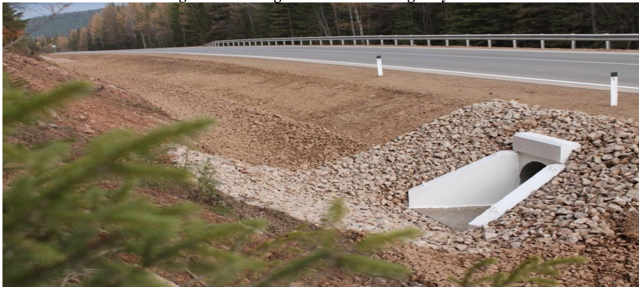
Расми 1. Иншооти обпарто дар шоҳроҳи автомобилгард Figure 1. Drainage facilities on the highway
